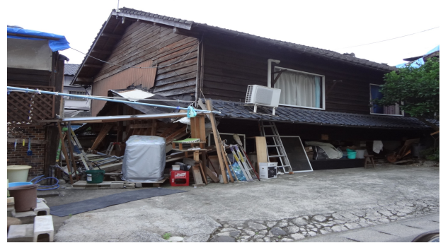
「1F部分がつぶれた木造家屋」
